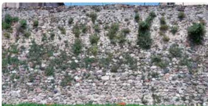
Muraglia lato sud da risanare
